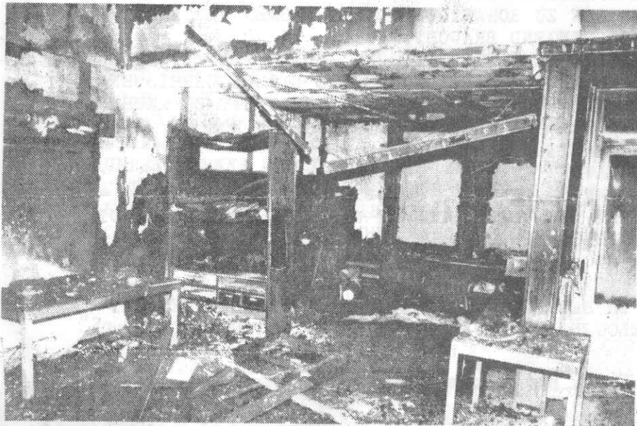
Verkohlte Balken, verschmorte Möbel und zerstörtes Kinderspielzeug: So sah der Gruppenraum der Hortkinder nach dem Brand aus.
